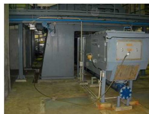
No.1沈砂搬出用コンベヤ
