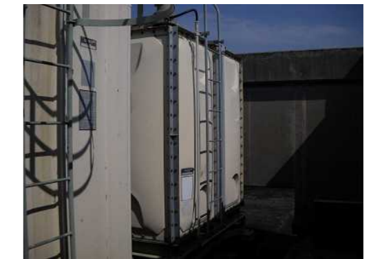
No.1、No.2高架水槽
