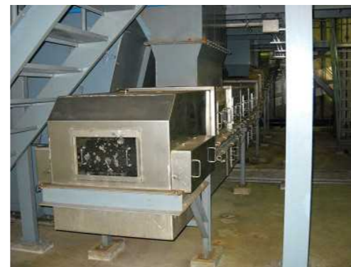
No.1スクリーンかす搬出用コンベヤ
