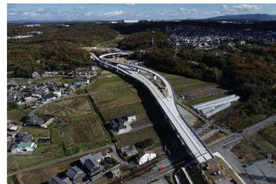
供用に向けて工事が進む 東播磨道(北工区) （三木市～小野市）
