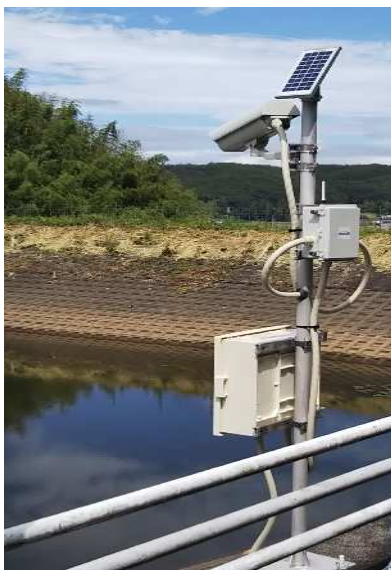
▲水位観測装置
