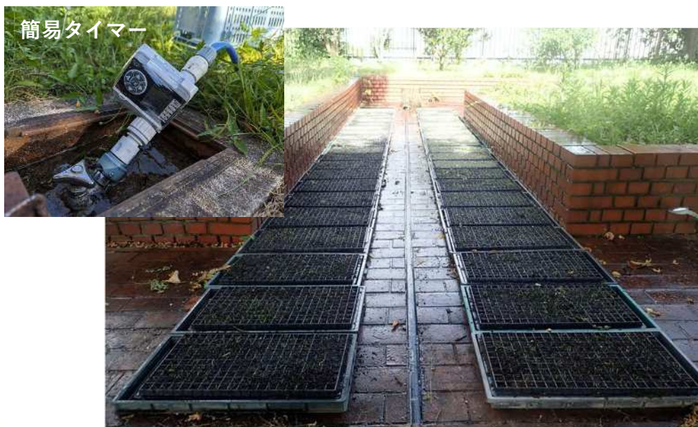
簡易タイマーと散水チューブによる自動散水
