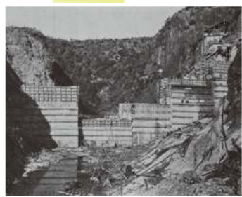
建設中のダムの様子 半分ぐらい打ち上がったところ。細かく分けてコンクリートを入れていることが分かります
