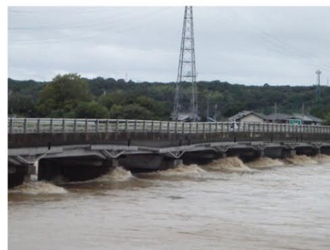
被災した粟田橋 (小野市)
