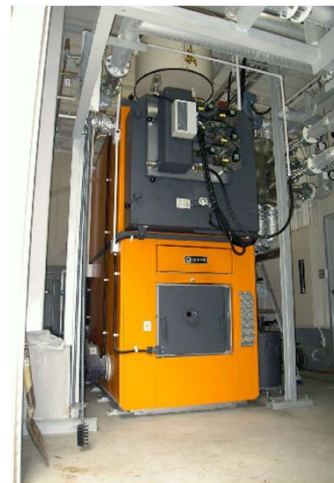
木質バイオマス チップボイラー
