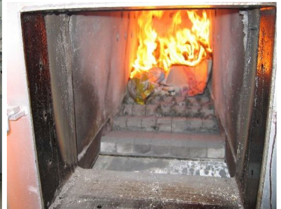
木質バイオマスチップボイラー (ボイラー内部)
