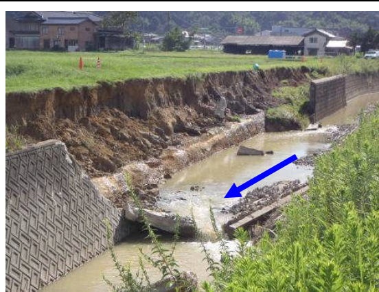
護岸の被災 (賀茂川 東剣坂町)
