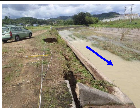
護岸の被災 (万願寺川 笹倉町)
