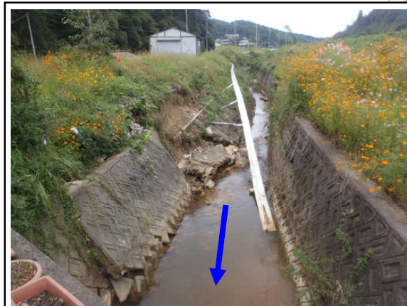
護岸の被災 (脇川川 三木市細川町脇川)
