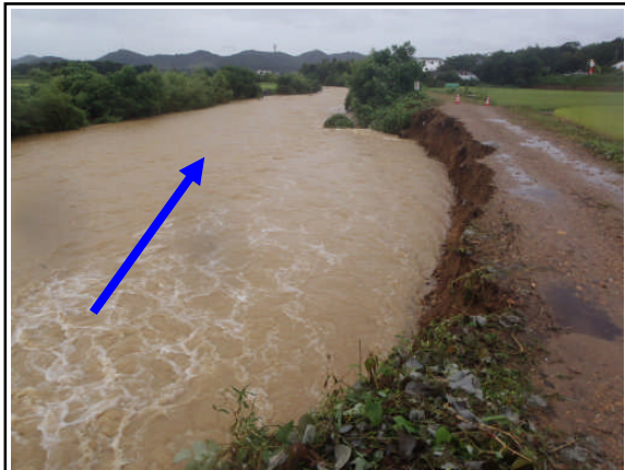
護岸の被災 (万勝寺川 小野市中町)
