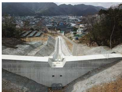
郷ノ瀬谷川 砂防堰堤 (西脇市)
