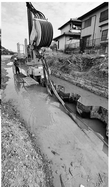
①法華山谷川の河川改修工事 ②高砂市 ③皇谷川の復旧現場を見学する生徒ら ④加古川市八幡町 ⑤「総合治水」の取り組みを見学 ⑥加古川運動公園
