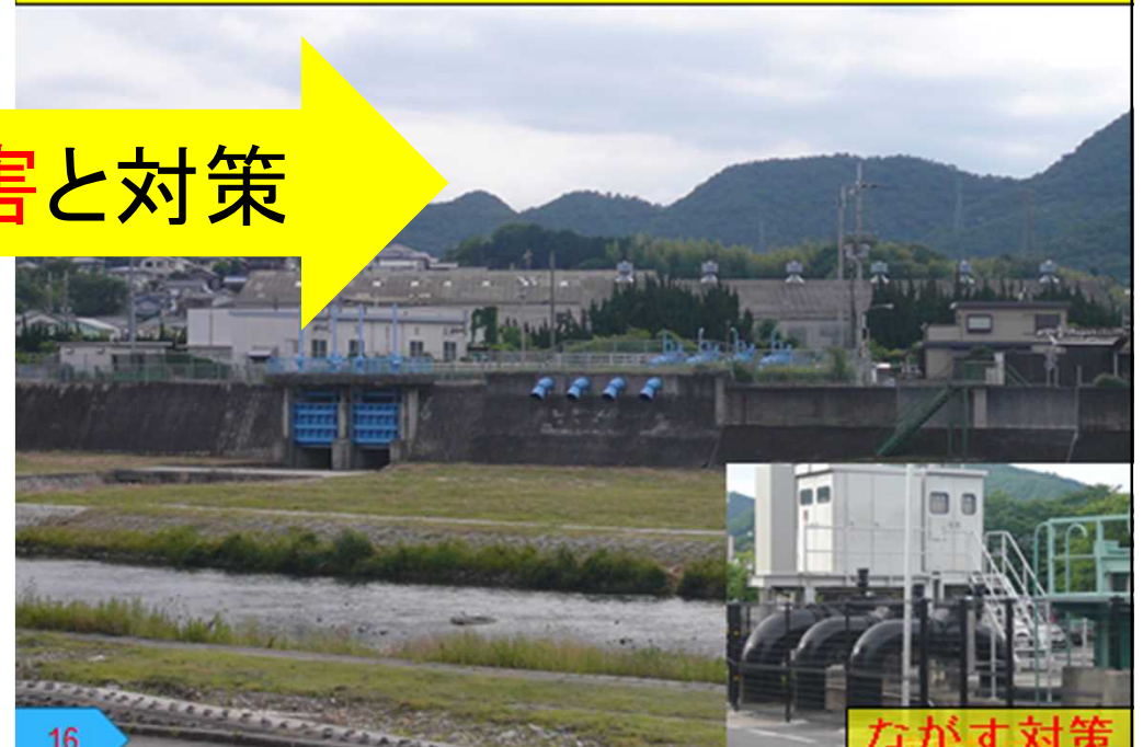
① その後の浸水対策3 (ポンプ場整備)
