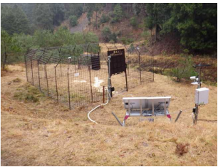
遠隔監視・操作が可能な捕獲施設
