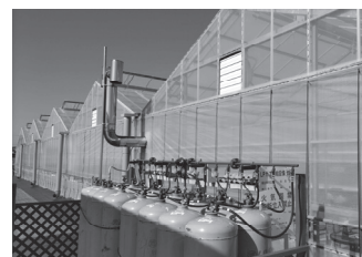
LPガスによる施設加温（加西市）
