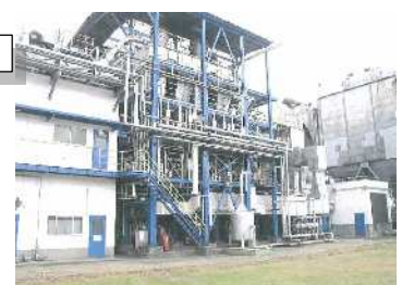
蒸気ボイラー施設
