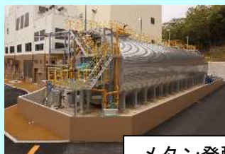
メタン発酵槽 (1,000m 3 )
