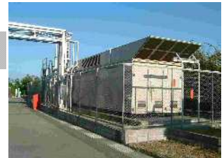
発電施設 (ガスエンジン)
