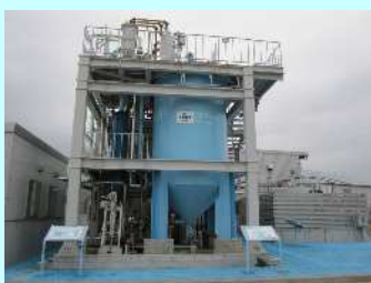
リン回収施設
