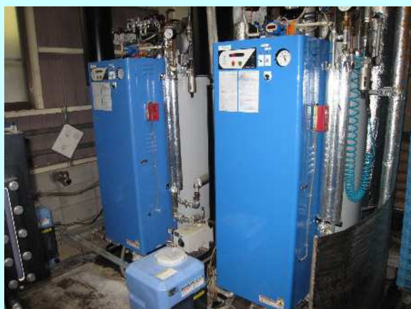
廃油ボイラー
