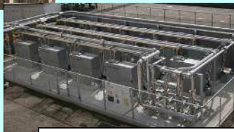
発電機 (25kW×14台)
