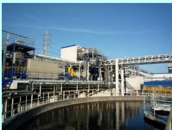
メタン発酵施設
