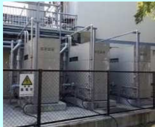
発電機 (25kW×3台)
