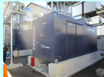
発電機(360kW×2台)
