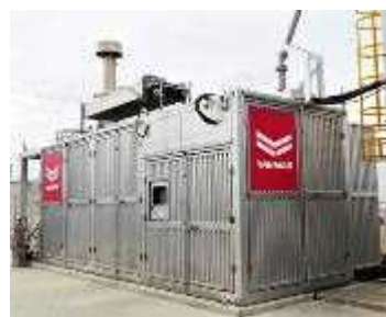
②ガス化発電炉
