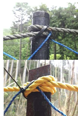
図 43 ずさんな施工(上)と正しい施工の例
