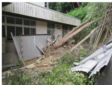
豪雨で被災した 小学校の体育館
