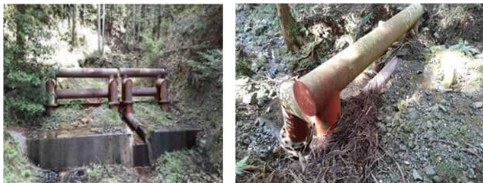
図Ⅲ－３－１ 簡易流木止め施設の状況(左：養父市、右：姫路市)
