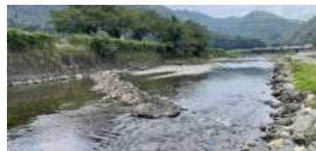
魚類の生息場に適した環境(寄州や瀬・淵)を創出するバープ工* *河岸から上流側に向けて構造物を設置する水制工法
