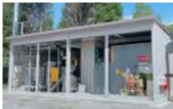
木質バイオマスボイラー(神戸市北区)
