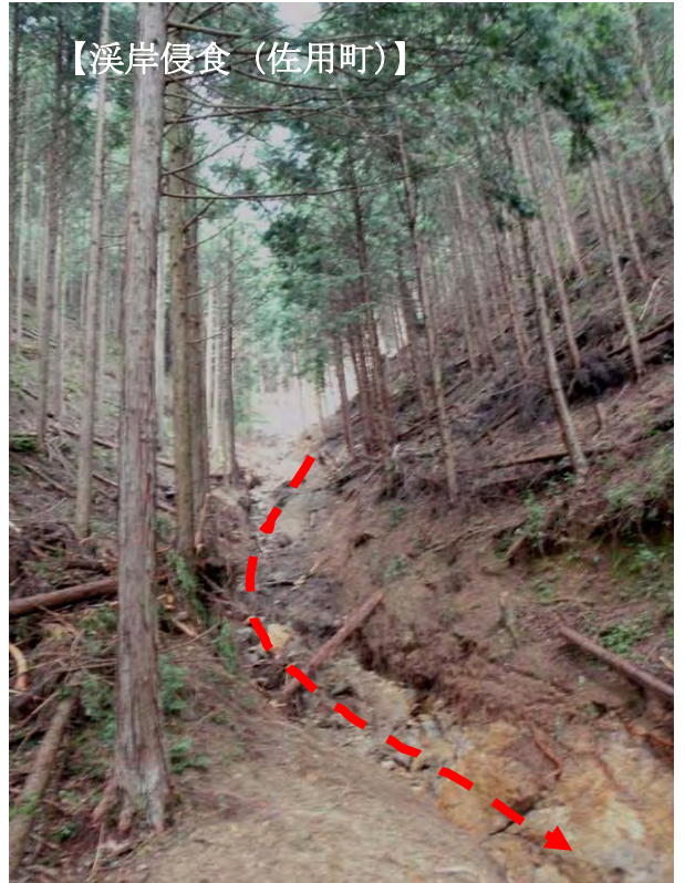
〔写真V-5-2〕 緊急防災林整備事業箇所への被災状況
