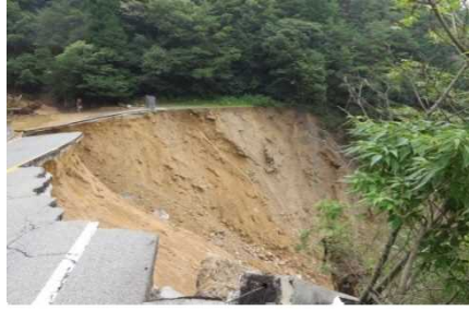
道路の崩落状況 (神戸市北区有馬町)
