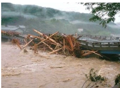
流木による橋梁閉塞で橋脚が沈下 （朝来市新井・立野）
