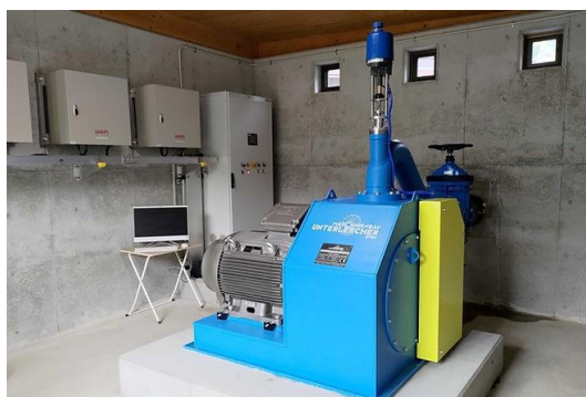
小水力発電所（さいたま市）
