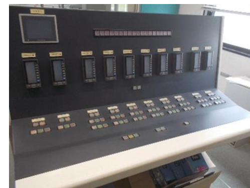
【三田 中央監視制御設備】
