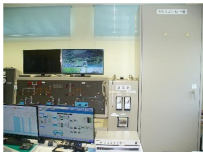
【揖保川 監視制御設備】
