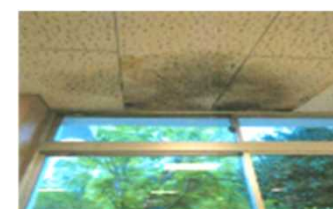
天井の雨漏り
