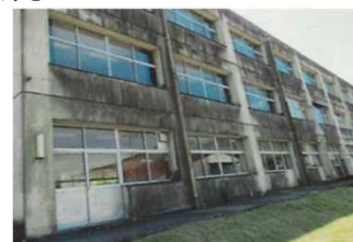
外壁塗装の黒カビによる劣化
