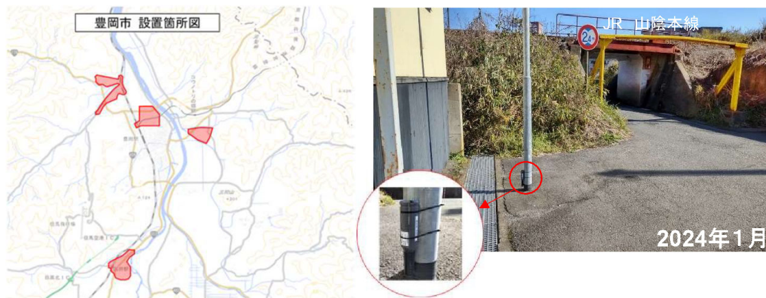
ワンコイン浸水センサーの設置（豊岡市）
