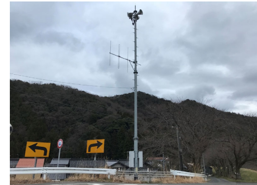
防災行政無線の設置（新温泉町）
