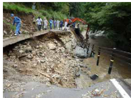
護岸崩壊による道路崩落箇所
