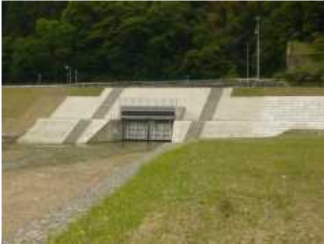
青山川樋門の設置 [平成27年6月完成] 樋門周辺の堤防嵩上げ [平成29年5月完成]
