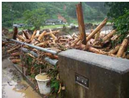
流木による橋梁箇所での閉塞状況
