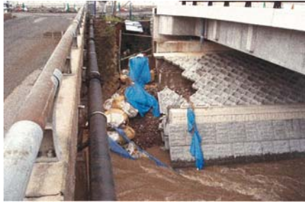
香住町（当時）油良の油良橋護岸の被災状況
