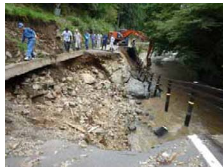
護岸崩壊による道路崩落箇所
