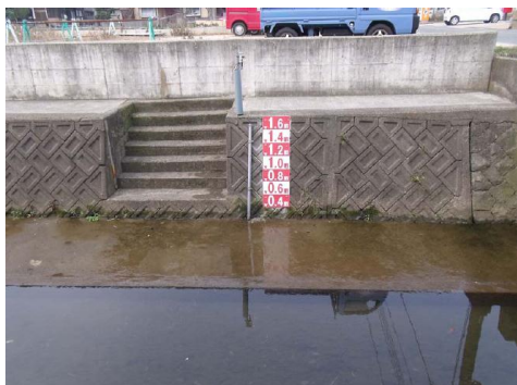
河川水位表示板の事例（香住谷川）
