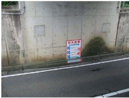
市道アンダーパス部の水位表示板
