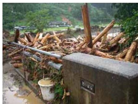
流木による橋梁箇所での閉塞状況
