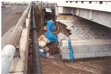
香住町（当時）由良の油良橋護岸の被災状況
