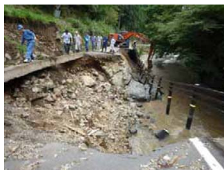
護岸崩壊による道路崩落箇所
