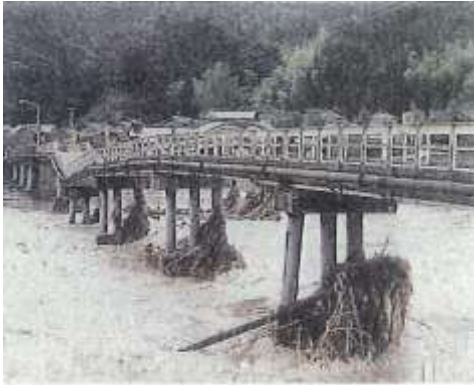
大野橋の被害状況(旧香住町香住区大野地先) (平成2年台風19号)
