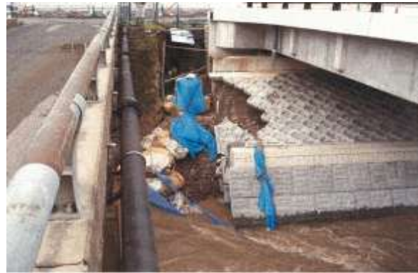
油良橋の護岸の被害状況(旧香住町) (平成16年台風23号)
