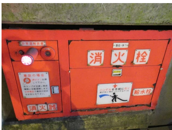
図-1 消火栓（更新前）
