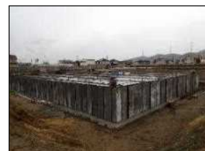
系引公園雨水貯留施設(姫路市) 令和元年7月完成
