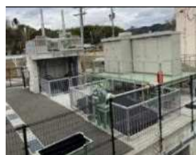
京口排水ポンプ場(丹波篠山市) 平成30年8月完成
