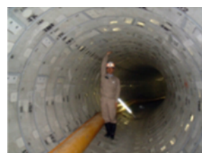
雨水貯留管 （左：西宮市 上：伊丹市）
