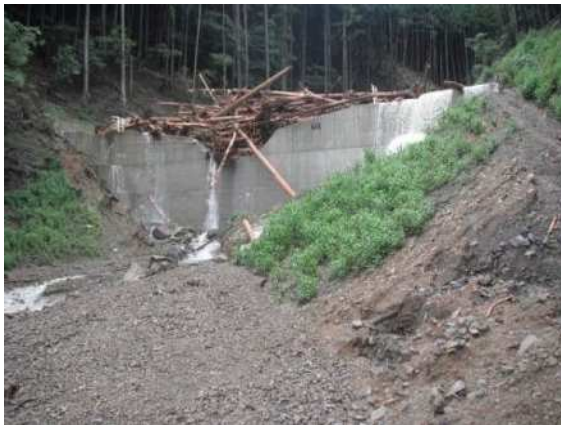
流木を補足した治山ダム （丹波市市島町中竹田地内）
