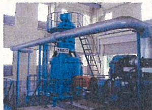
1号主ポンプ設備 (11年経過)
