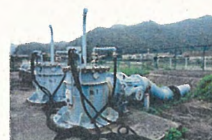
久崎救急内水排水機場 主ポンプ設備(17年経過)
