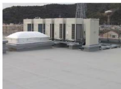
空調施設(屋上)
