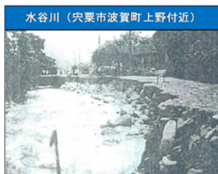
S45.8 被災状況
