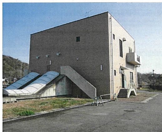
佐方ポンプ場
