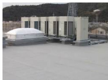
空調施設(屋上)
