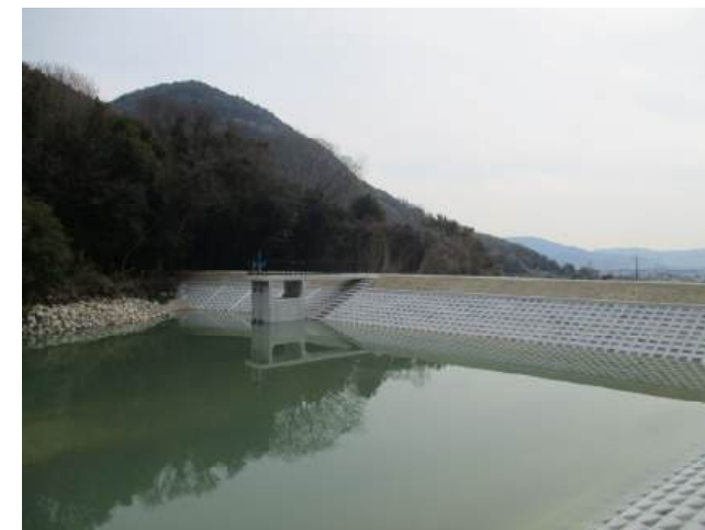
事前放流設備（取水施設改良型）を整備した折方新池（赤穂市）
