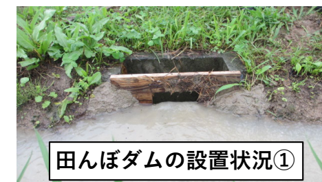
③田んぼダムの設置状況（たつの市）
