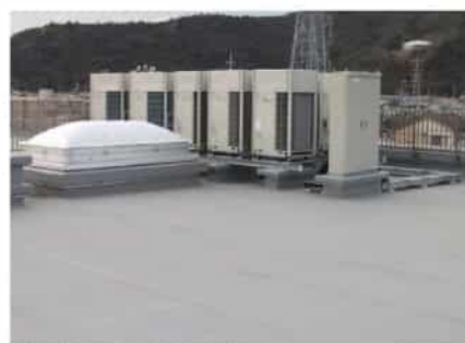
空調施設(屋上)
