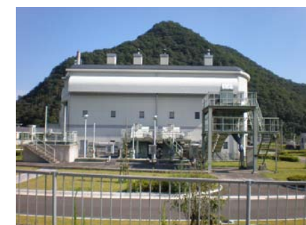
駅前雨水ポンプ場(上郡町)
