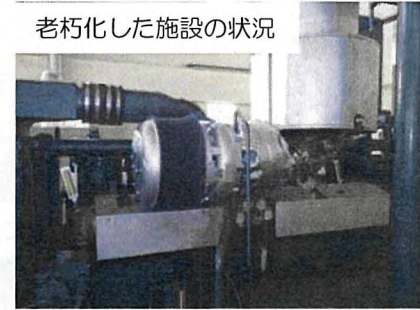
老朽化した施設の状況 過給器 (9年経過)
